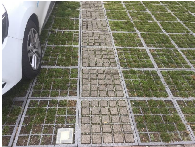
Figure 11 : photo d'un parking équipé de dalles alvéolaire en PEHD (Cerema)
