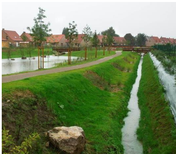
Figure 17 : photo d'un fossé, ZAC du Blanc Balot à Santes (crédit photo : Max Lerouge – Métropole Européenne de Lille)
