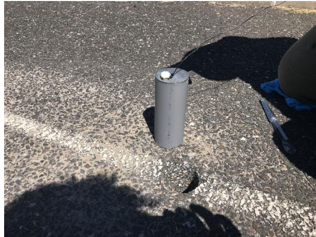
Figure 4 : intégration du capteur dans la chaussée
