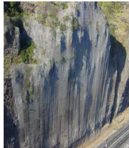
Figure 3 : falaise surplombant la RN1
